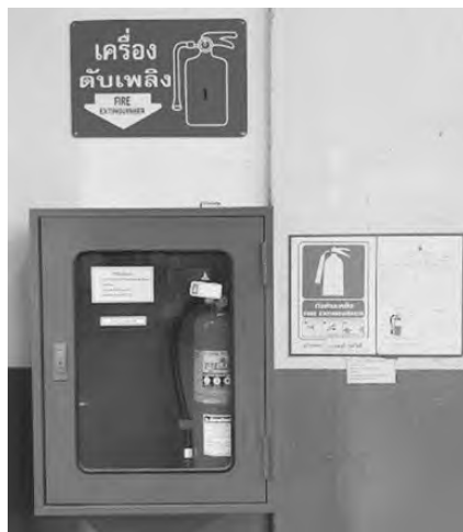
รูปที่ 1.12 จุดที่ติดตั้งถังดับเพลิง ที่มา : ถ่ายภาพโดยผู้เรียบเรียง
