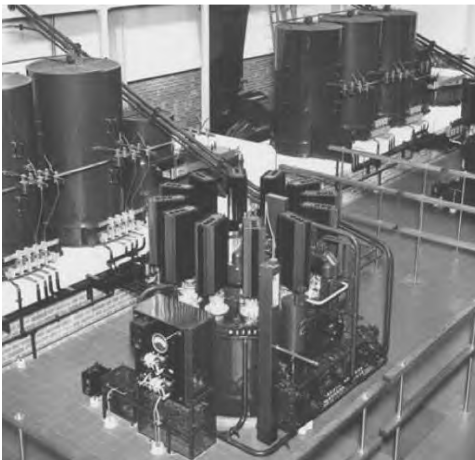
รูปที่ 1.3 สถานีเรียงกระแสไอปรอท ที่สถานีจ่ายไฟ Arnos Grove สาย Piccadilly รถไฟใต้ดินกรุงลอนดอน ปี ค.ศ. 1933
