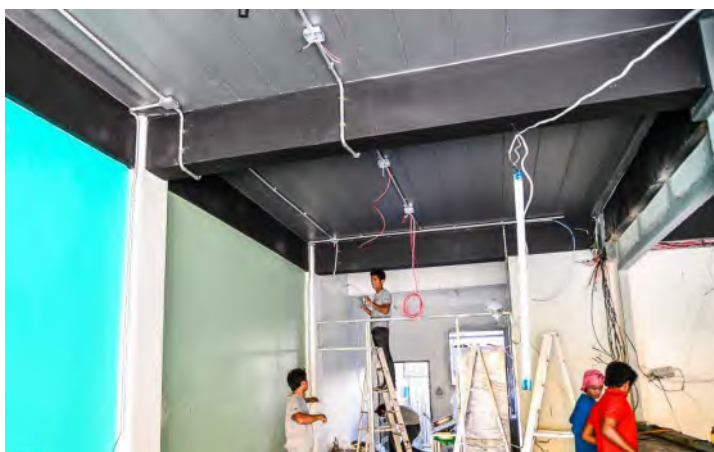
รูปที่ 1.5 งานไฟฟ้า
