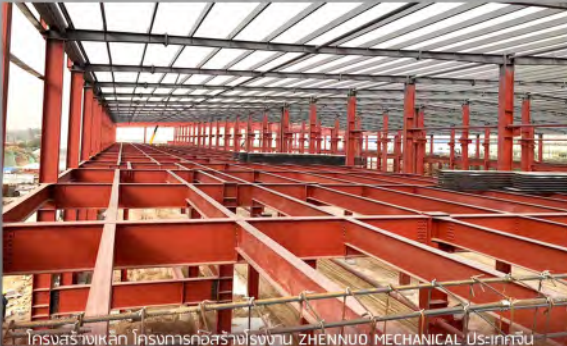
โครงสร้างเหล็ก โรงงานก่อสร้างโรงงาน ZHENNUO MECHANICAL ประเทศไทย
