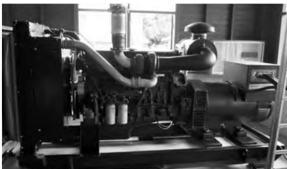
รูปที่ 2-3 เครื่องกำเนิดไฟฟ้า
