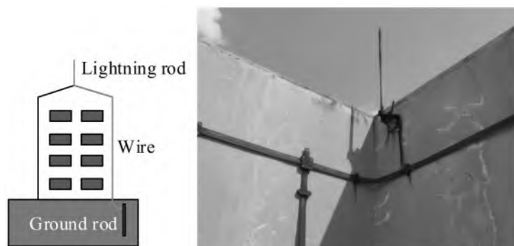
รูปที่ 2-6 lightning arrester/lightning rod
