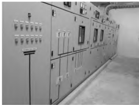
รูปที่ 2-2 main distribution board (MDB)
