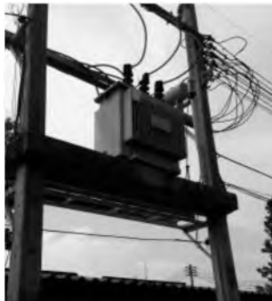
รูปที่ 2-1 หม้อแปลงไฟฟ้าแบบน้ำมัน
