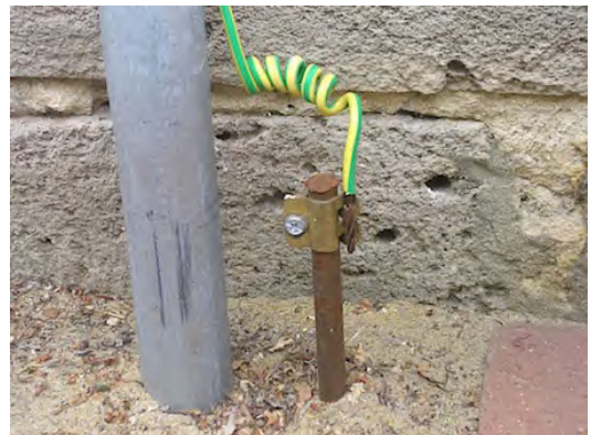
รูปที่ 1.11 หลักดินและการต่อสายดินเข้ากับหลักดิน
