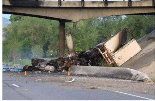
(ข) รถชนเสาตอม่อสะพานริมทาง (Isaac et al., 2010)
